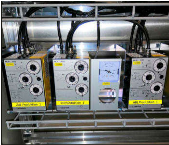
Bild 3: Auch die Daten der Volumenstrom- und Raumdruckregler im Produktionsraum des Kunden wurden in das virtuelle Modell übertragen.
